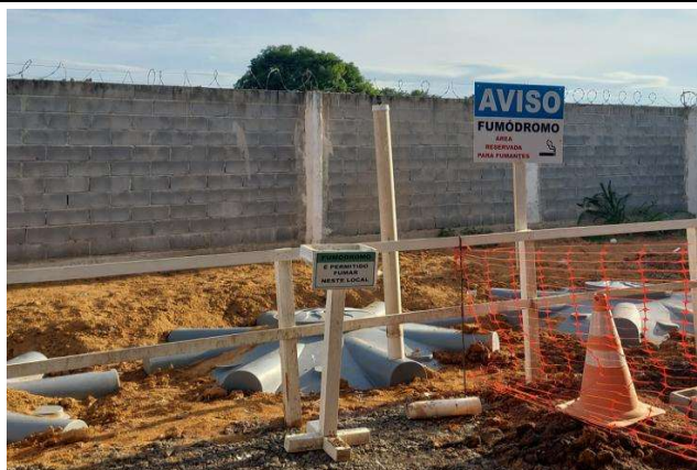
Sinalização de área para fumo – Fumódromo.
