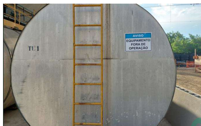
Sinalização para equipamentos fora de operação.
