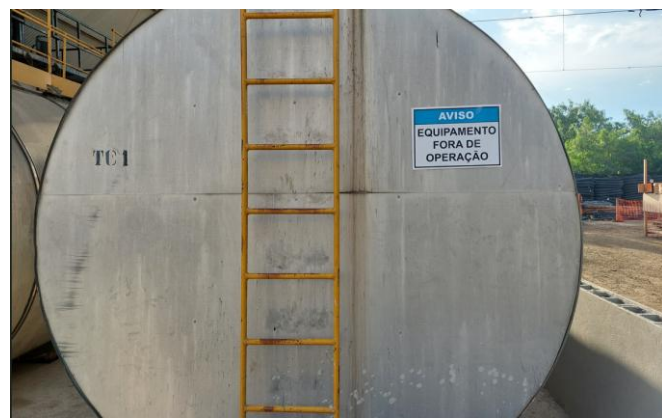
Sinalização para equipamentos fora de operação.
