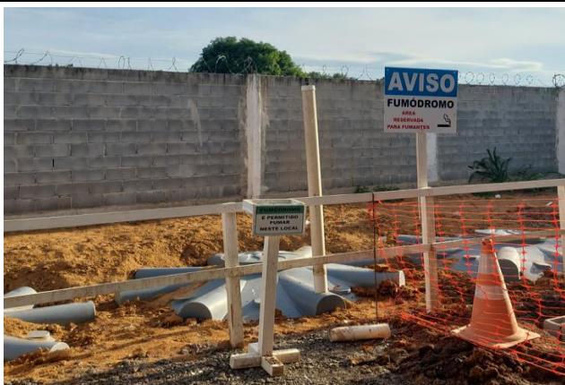
Sinalização de área para fumo – Fumódromo.
